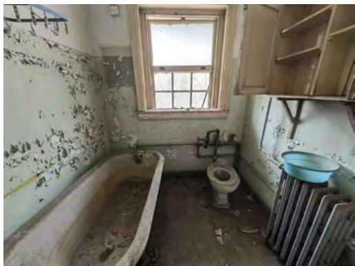
图 13 54 号别墅整修前卫生间内景。
